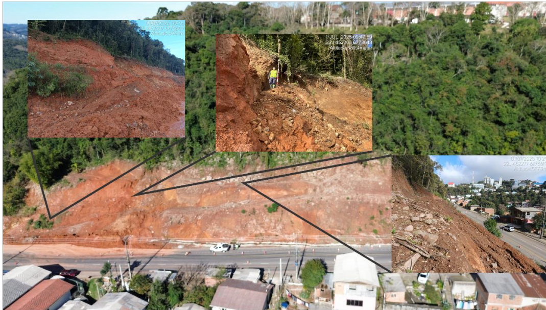
Figura 4. Características geotécnicas observadas no talude.
